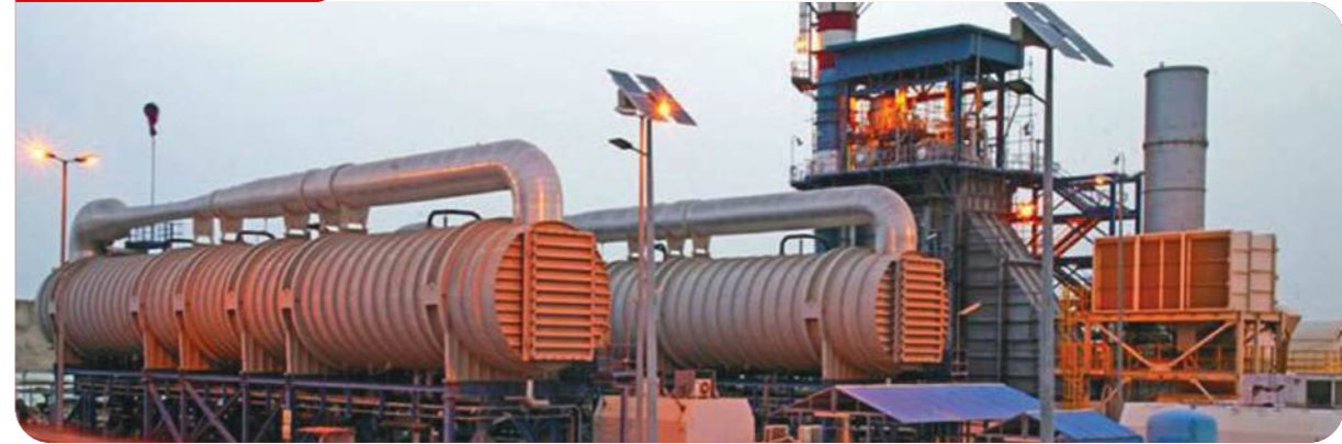
پروژه‌های بسته‌های آب
