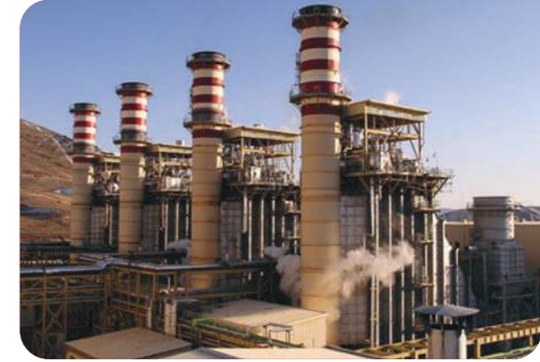
پروژه‌های بویلر باز یافت HRSG
