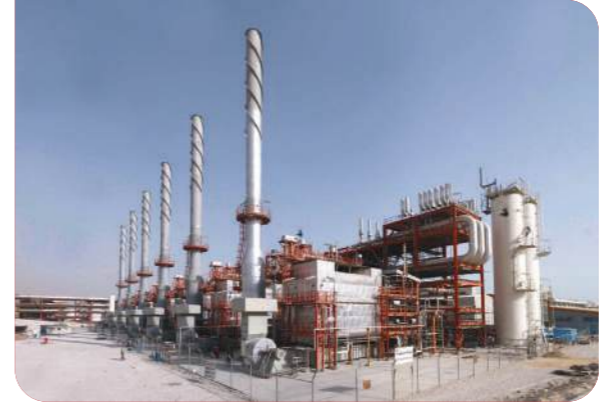
پروژه‌های بویلر واترتیوب (Industrial)
